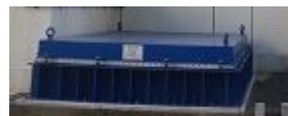
図 1 浸水防止扉等の設置
