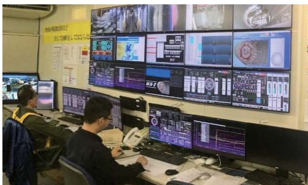
図1 シールドマシンの中央管理室
